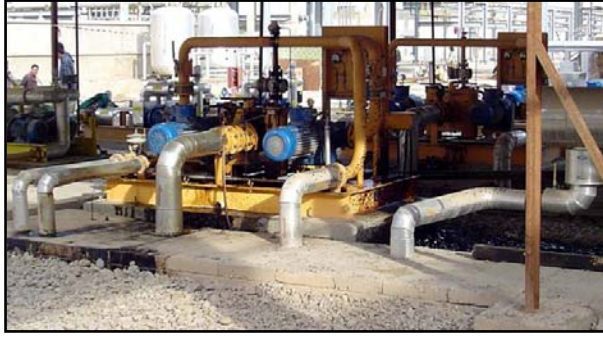
مشروع القدس للطاقة الكهربائية ، مضخة نقل النفط الخام.
