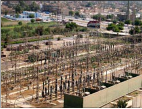
مشروع الدورة للطاقة الكهربائية. الصورة: USAID
