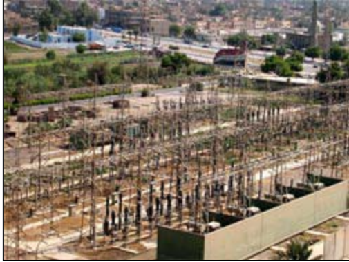
: مشروع الدورة للطاقة الكهربائية. الصورة : USAID
