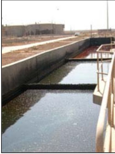
المياه الثقيلة في مشروع الكرخ لمعالجة المجاري.
